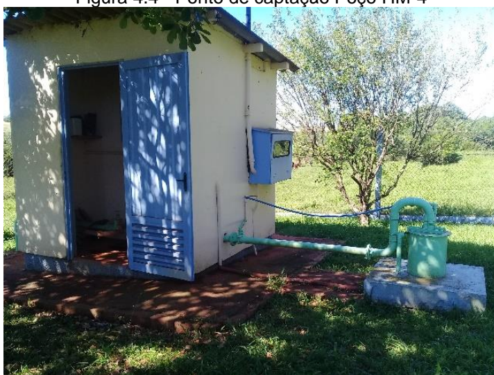
Figura 4.4 - Ponto de captação Poço HM-4
