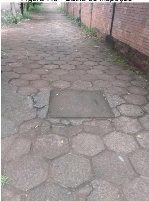
Figura 7.5 - Caixa de inspeção
