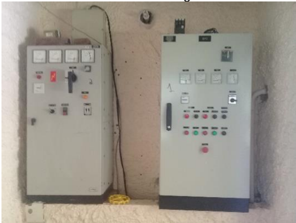
Figura 4.11 - Quadro elétrico da Estação de Tratamento de Água
