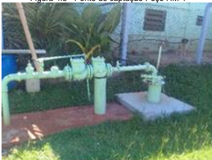
Figura 4.3 - Ponto de captação Poço HM-1
