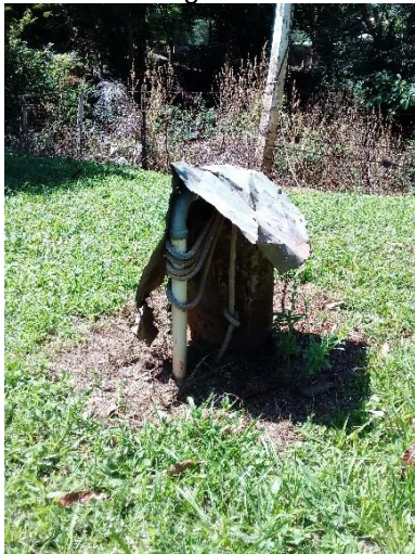
Figura 4.26 – Ponto de captação da Localidade de Sanga Severino
