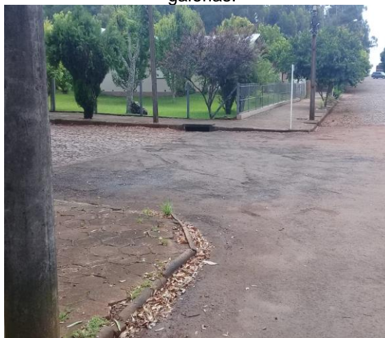
Figura 7.2 - Drenagem em área asfaltada, galerias.
