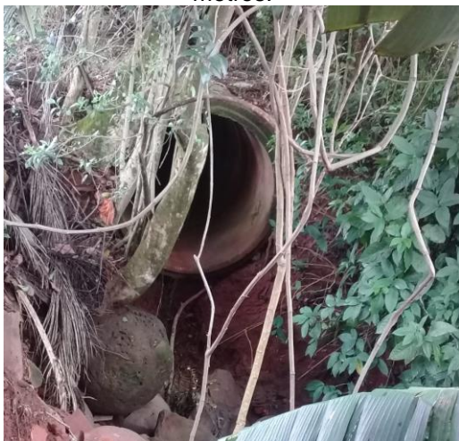
Figura 7.1 - Fim da microdrenagem urbana, com tubos de diâmetro de 1,5 metros.
