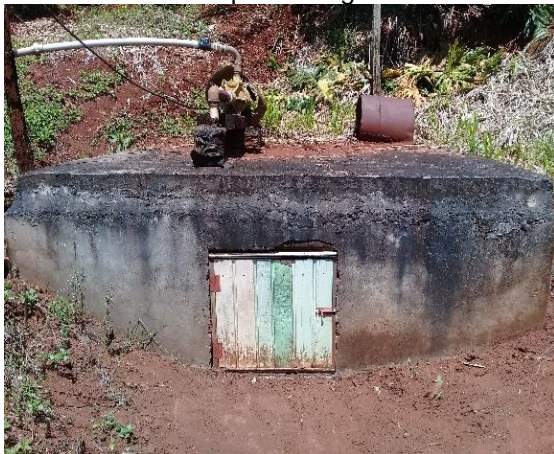
Figura 4.28 – Ponto de captação da Localidade de Esquina Funqueto
