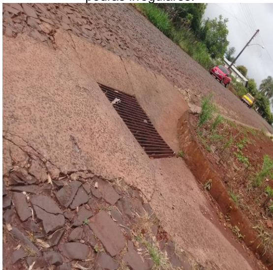
Figura 7.4 - Drenagem em área calçada com pedras irregulares.
