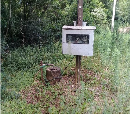
Figura 4.19 – Ponto de captação da Localidade de Herval Novo
