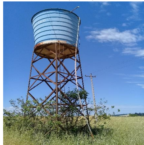
Figura 4.43 - Reservatório da localidade de Linha Frizzo
