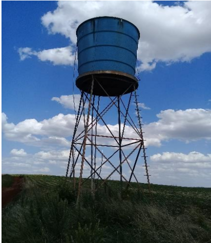
Figura 4.50 – Reservatório da localidade de Herval Grande Natal Diesel
