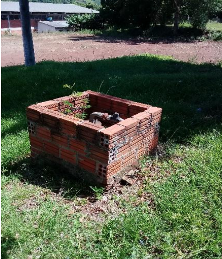
Figura 4.21 – Ponto de captação da localidade Sanga Freitas A
