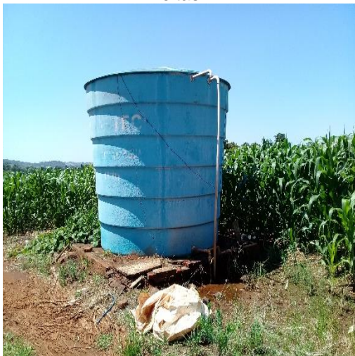
Figura 4.42 – Reservatório da localidade Sanga Freitas A
